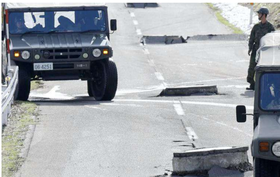
(甲 B 1 4 9・石川県珠洲市・地震によって突き出たマンホール)
